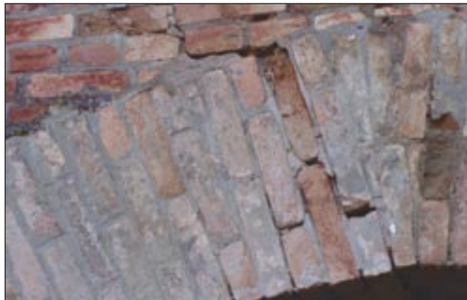
5/6 kép A boltívben keletkezett repedések
