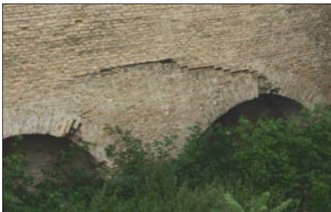
5/4 kép Az Öregvár kis udvarában keletkezett repedések
