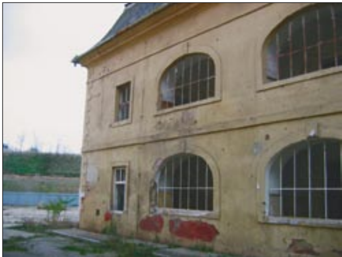
4/1 kép A Kaszárnya - épület teljesen tönkrement folyosó ablakai
