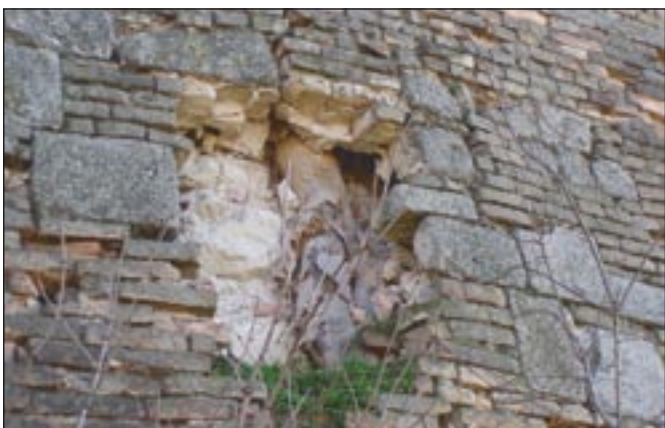
5/3 kép A növények által okozott károsodás a falban
