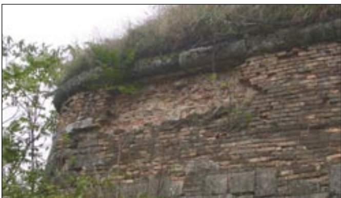
4/3 kép A nyersfalak homlokzatának jellegzetes károsodása
