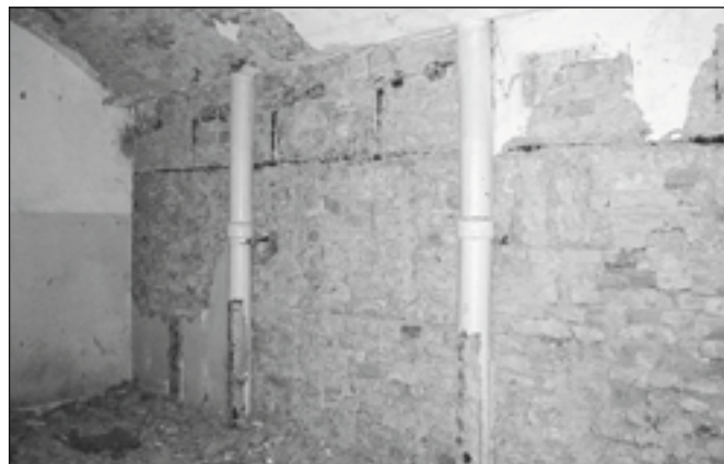
6/2 kép A másodlagosan kiépített csatornahálózat már használhatatlan
