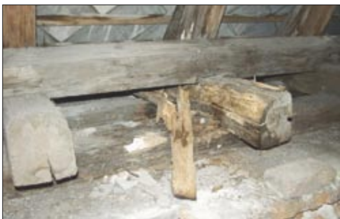
5/5 kép A beázások okozta károsodások a tetőszerkezetben
